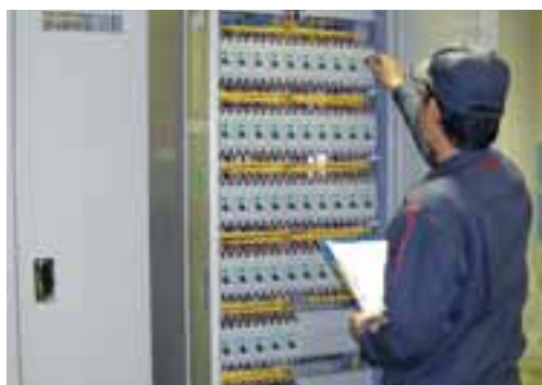
分電盤動作試験
