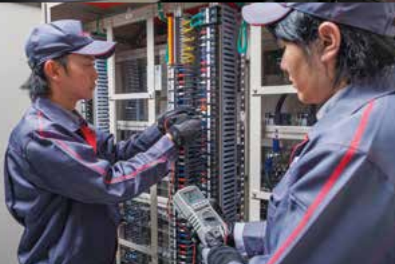
電源装置試験
