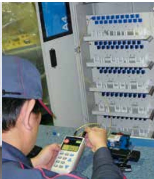
光配線盤光コード損失測定
