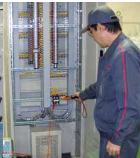
分電盤動作試験
