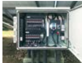
PV用SPD盤 (PV用接続箱)
